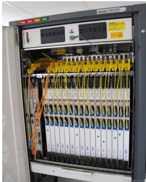
Figure 12 : Photo d'un Terminal de Ligne Optique.
