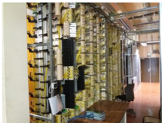
Figure 11 : Photo du répartiteur optique AX3 (Aix-en-provence).
