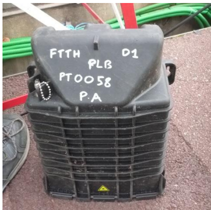
Figure 15 : photo d'un Point d'Aboutement
